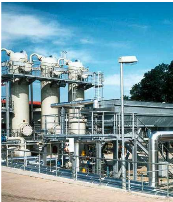
5 Der Erdgasspeicher in Fronhofen
